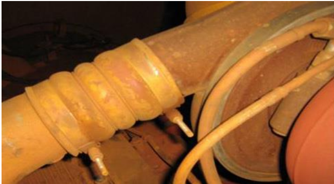
Figura 5: Ejemplo de la manguera que se desprendió del turbocargador y del refrigerador posterior.
